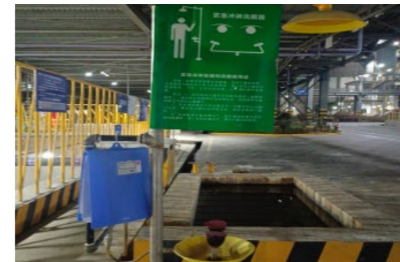
雅安锂业硫酸罐区喷淋洗眼器
