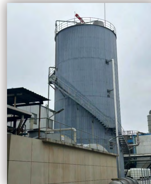
废水处理装置
