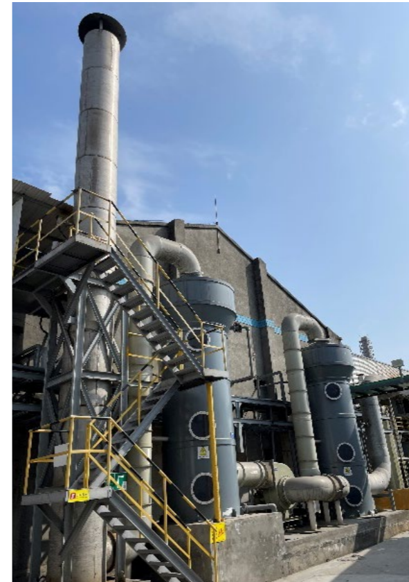
焙烧窑尾气喷淋塔
