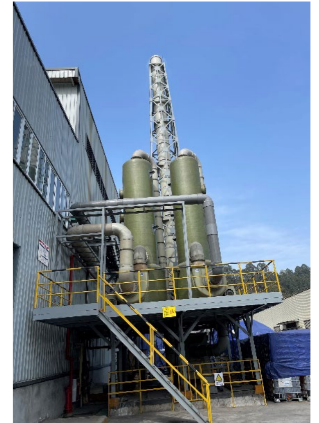
沉淀与萃取废气喷淋塔
