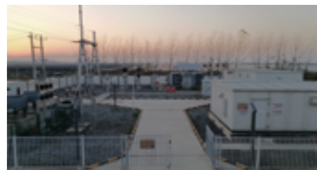
監利項目變電站
