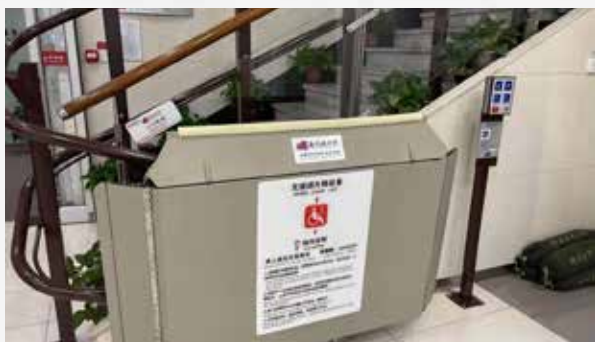
图：网点无障碍设施
