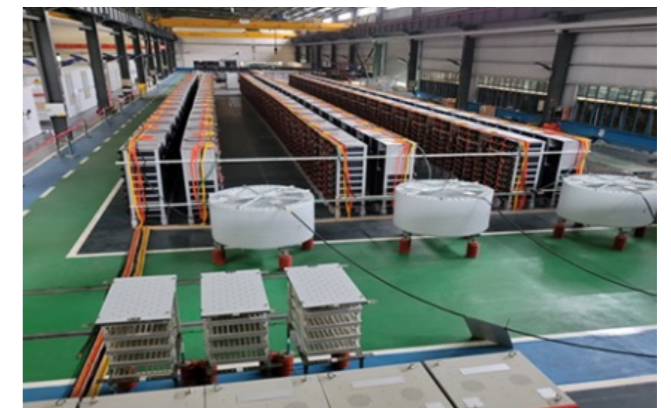
35kV 级联高压储能系统
