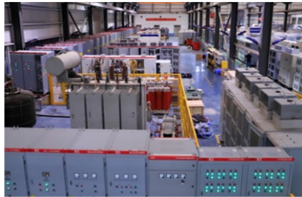
高压大功率电力电子测试室
