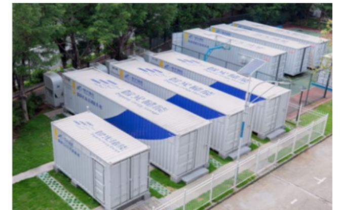
5MW 储能实验平台
