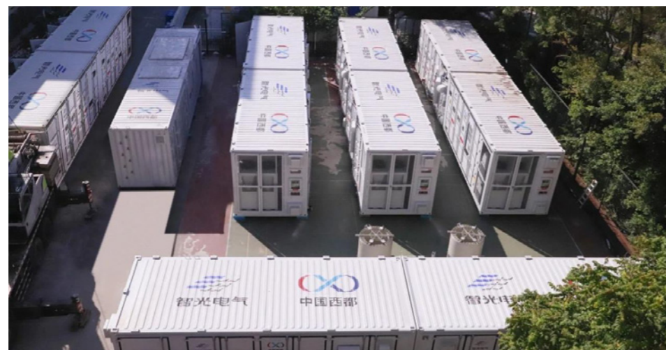
● 全球最大 35kV 级联型高压液冷储能电站 200MW/400MWh 储能系统
