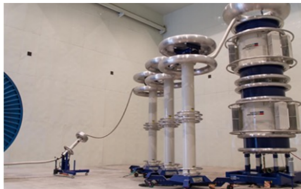
电缆高压局放测试实验室
