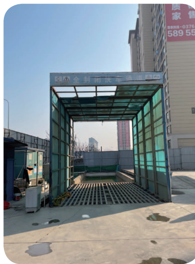
設置於工地出入口車輛清洗塵埃設施
