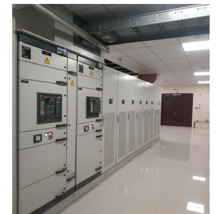
10kV直转380V直流电源系统
