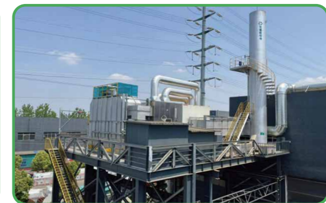
生产废气经除尘设备预处理,通过三级过滤+沸石转轮+RTO高效治理设备再处理后实现超低浓度排放
