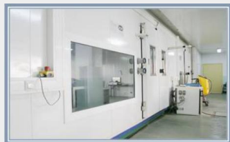
空调系统测试台
