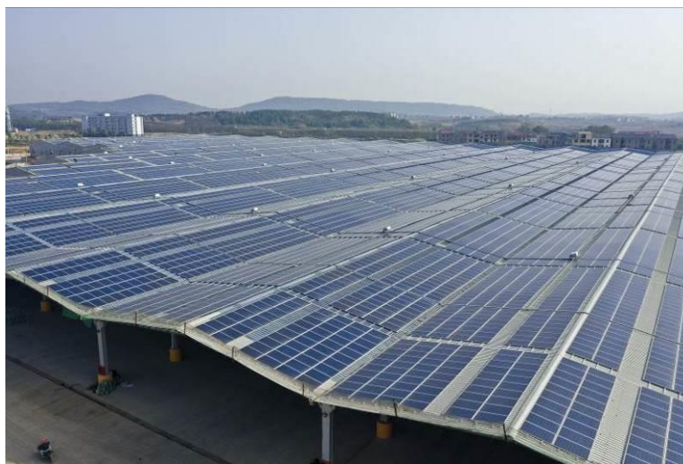
发行人江西丰城生产基地光伏厂房
