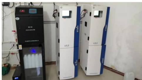
六安市皖兴羽绒有限公司水污染源排放连续监测系统
