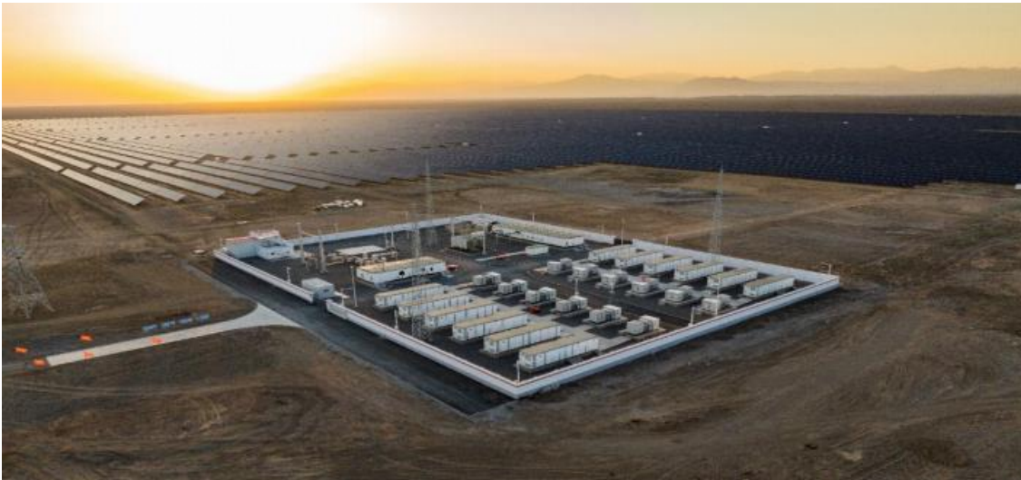
吐哈油田 120MW 源网荷储一体化项目
