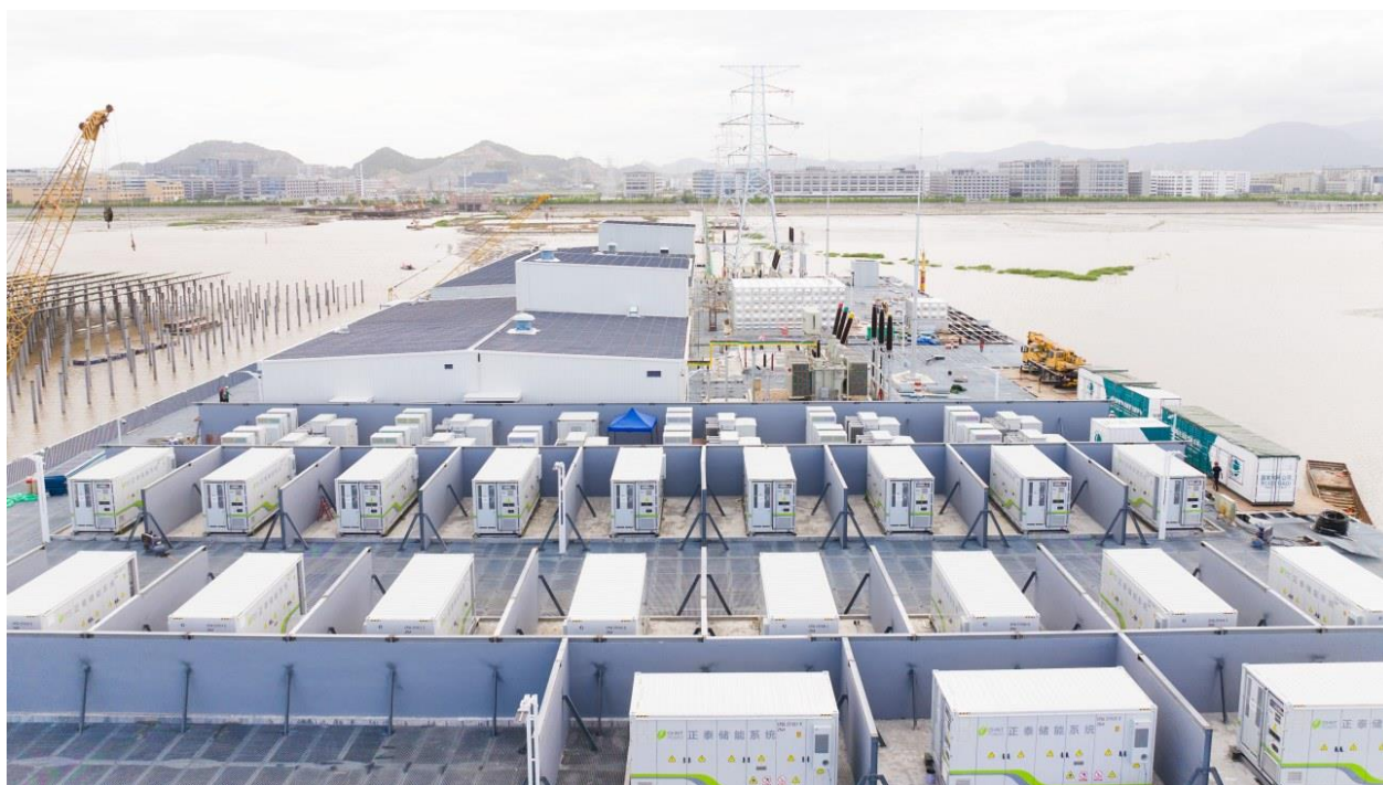
图 1：温州乐清湾 50MW/100MWh 共享储能电站项目
