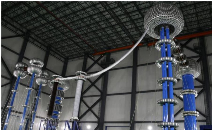
亨通超高压电力测试技术中心
