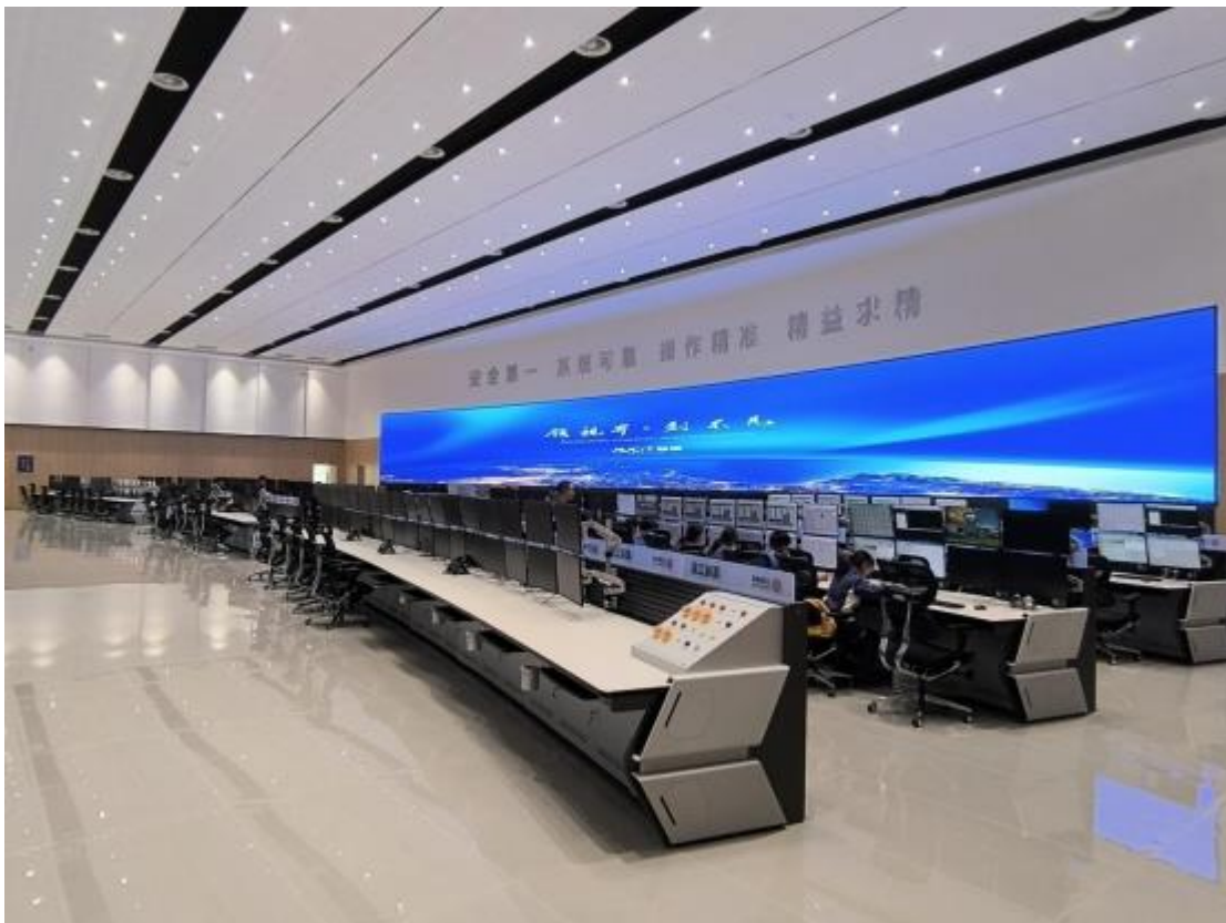
云南通威绿色能源项目调度大厅
