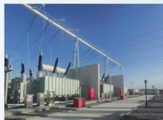
新能源变压器
