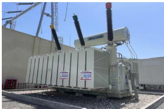
华润汾西 100MW 光伏复合项目
