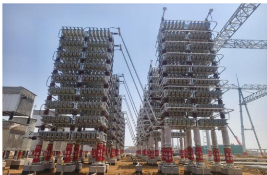
陇东-山东±800kV 特高压直流输电工程
