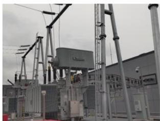
S35-500kV电力变压器
