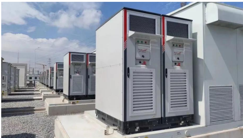
科华构网型储能应用项目
