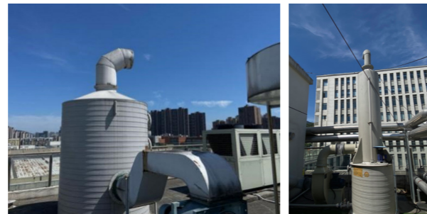
活性炭吸附塔 ▲ 水洗塔 ▲
