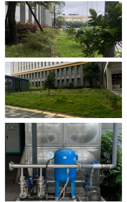
循环废水绿化喷淋系统 ▲
