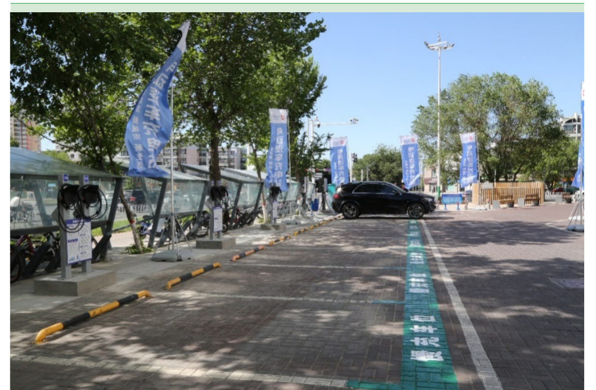
公司新能源充电站
