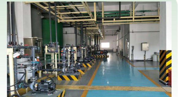
公司电厂脱硫废水设备
