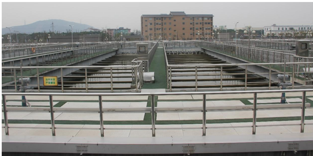
注：非金属链板刮泥机应用图示
