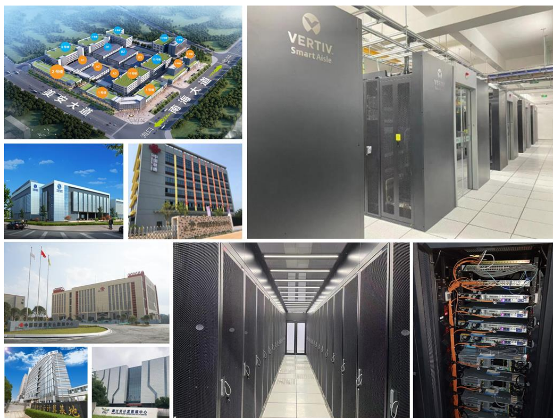
图 1 数据中心机房、监控中心、机柜机架
