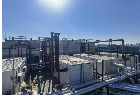
酒仙桥数据中心冷站
