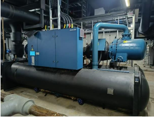
中金云网数据中心余热回收系统
