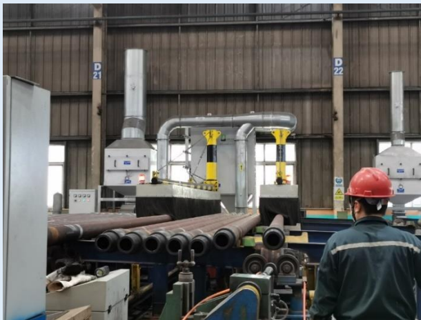
上海鑽具新增除塵設備
