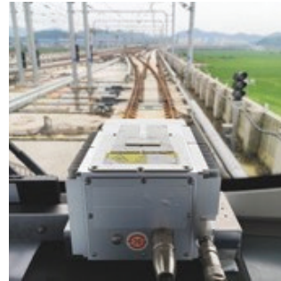
安裝在列車上 (內部視角)
