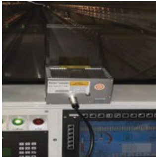
安裝在地鐵列車上
