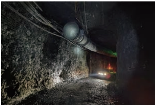
主斜坡道輔助風機
