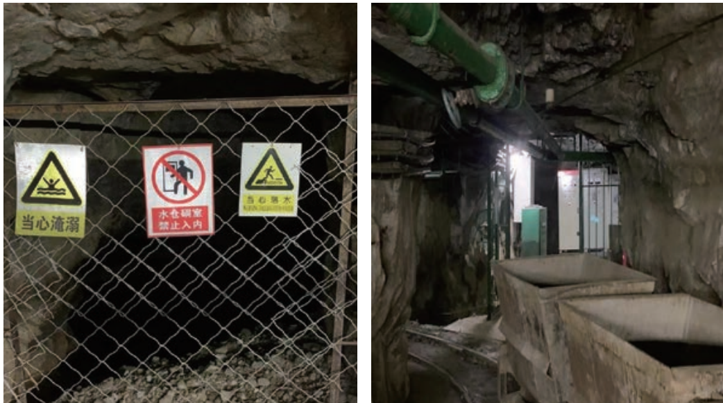
圖10-8：蓮花山5號採區五中段集水坑及主變電站照片
