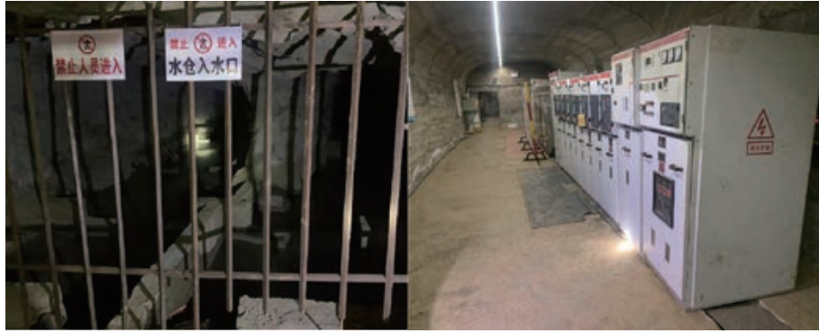
圖10-21：東風礦平硐層主集水坑及變電站照片
