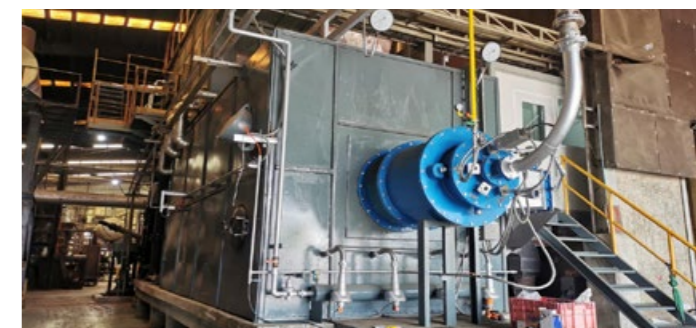
泰国首套多元燃料锅炉系统投入运行
