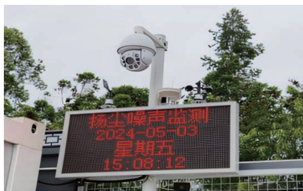
出入口安装TSP在线监测设备
