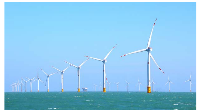
南澳勒门I海上风电项目
