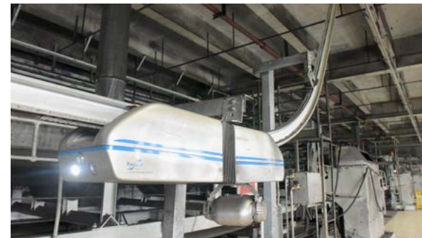
蔚州能源公司输煤栈桥轨道式智能巡检机器人
