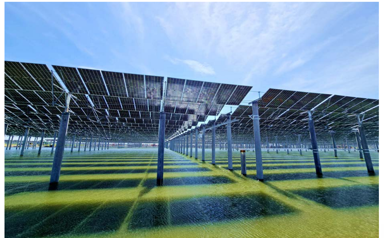
唐山新能源公司曹妃甸三农场渔光互补项目
