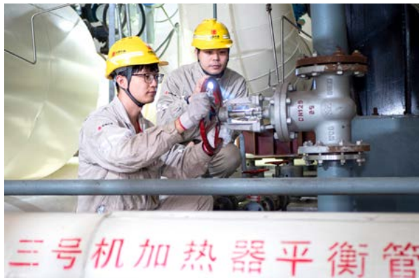
盘山发电公司扎实开展供热设备巡检工作
