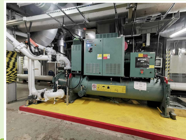
高效能的夜間負荷製冷設備
