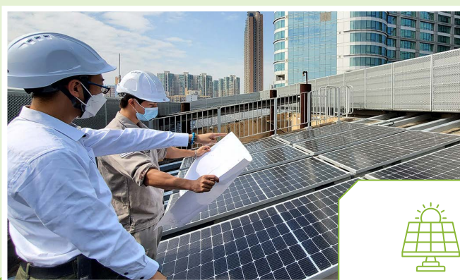
頂樓的太陽能光伏板
