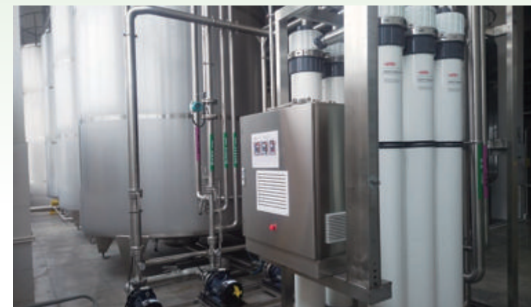
▶ 随州公司超濾水處理設備
