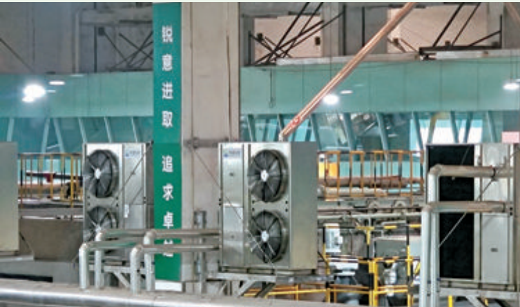
空气源热泵机组
