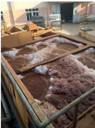
J.Y. Plasteel 透過微生物處理生活污水
