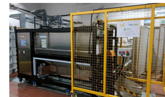
圓方商場的「廚餘再生俠」提供有效的廚餘處理方案
