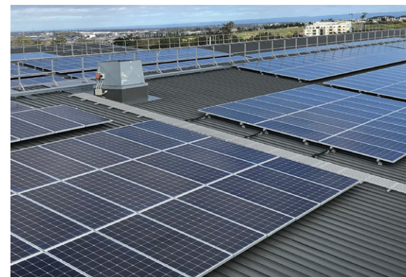
Metro Trains Sydney 設施配備超過 3,000 塊太陽能板
