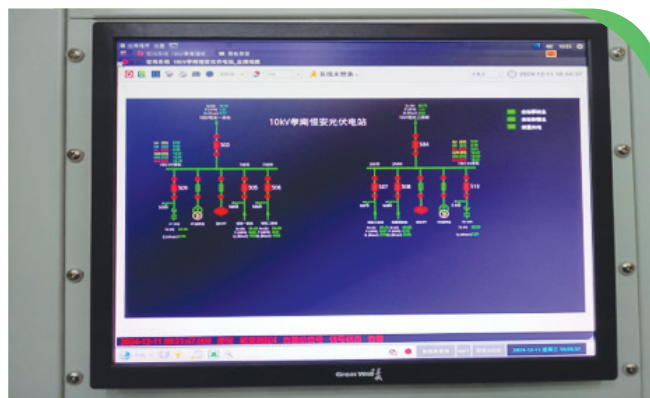
New Energy Management Platform 新能源管理平台
