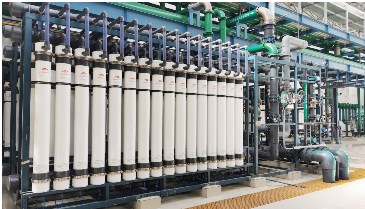
陕西公司矿井水深度处理设备，将处理后的矿井水投入循环利用
