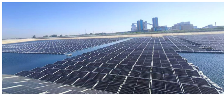
西北公司母杜柴登矿井光伏项目
