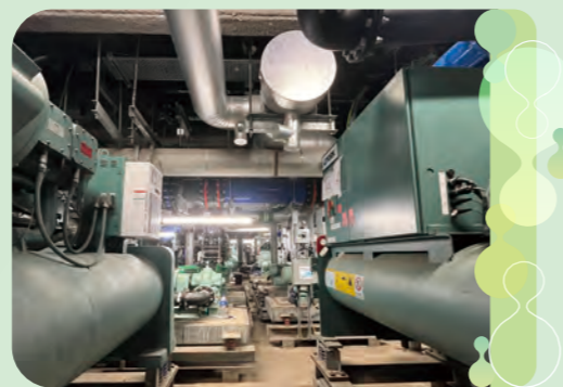
冷凍水機組經過重新調試，大幅節省能源。
