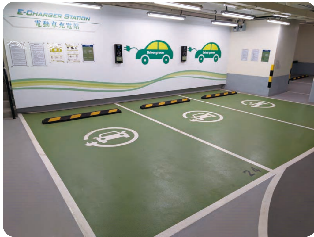
長江集團中心的停車場已安裝電動車充電樁，推動可持續發展計劃。
