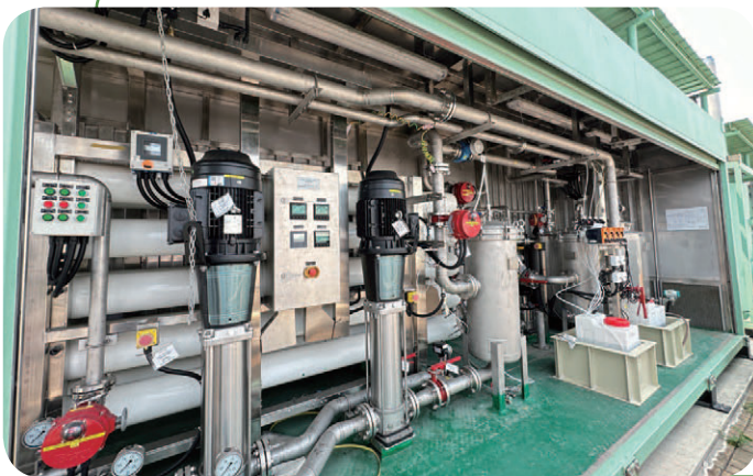
▲ 南丫發電廠設有除鹽裝置濃水回收系統，有助回收廢水。
