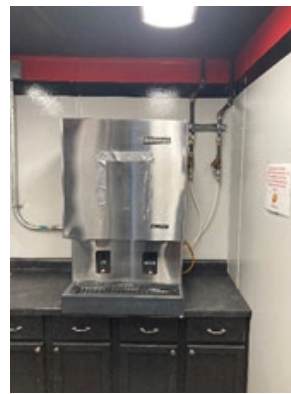
使用冷卻塔水的製冰機照片
