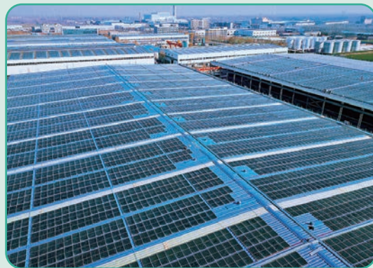
华能河南延津屋顶分布式光伏项目
