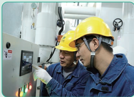
清洁能源供暖项目提前开栓供热
