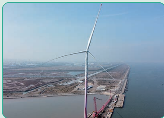
华能天津港50兆瓦风电项目
