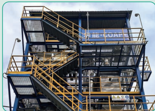
华能岳阳燃煤烟气二氧化碳捕集中试装置
