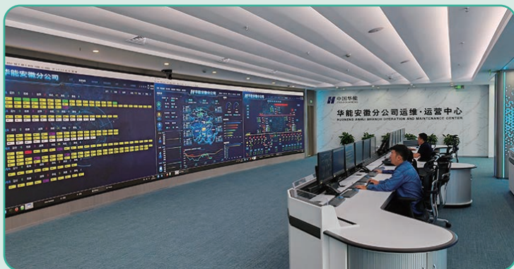
华能安徽分公司智慧运维运营中心
