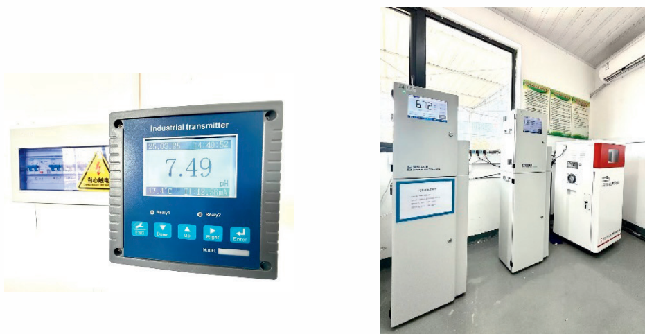
廢水在線監測設備
