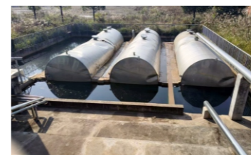
湘窖蒸餾冷卻水循環系統
