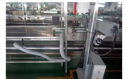
包裝除煙塵系統
