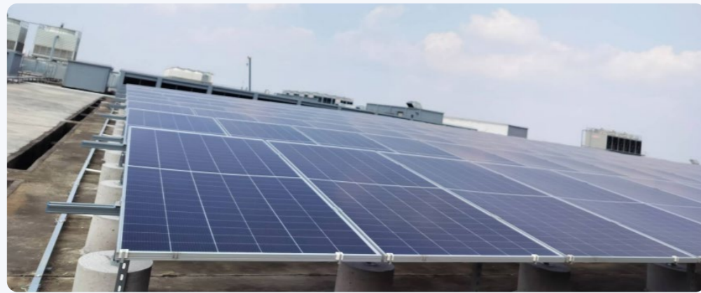
廠房樓頂光伏項目
