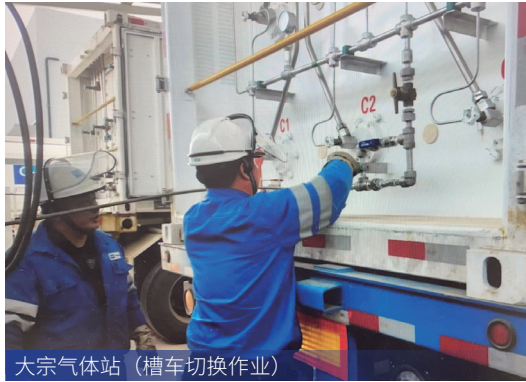
大宗气体站（槽车切换作业）
