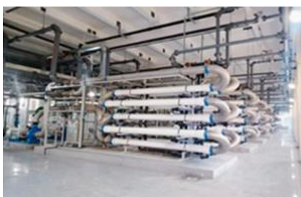
华电集团邹县电厂软化除硬项目
