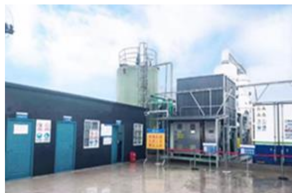
湖北洪湖渗滤液全量化处理项目
