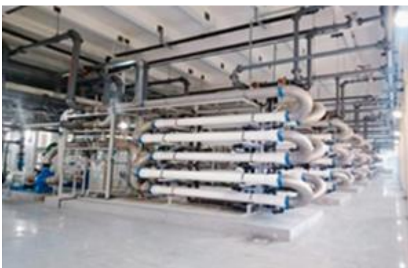
华电集团邹县电厂软化除硬项目
