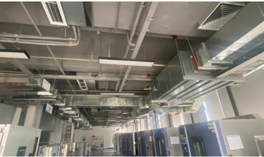
产业园实验室新风交换系统
