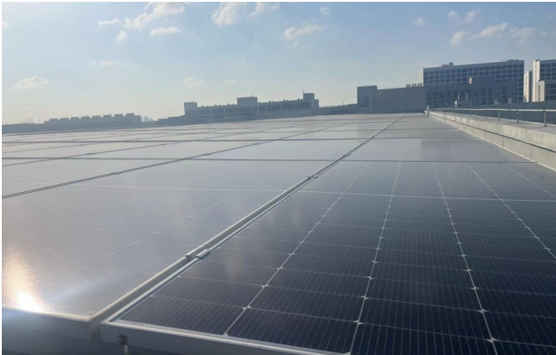
产业园屋顶光伏
