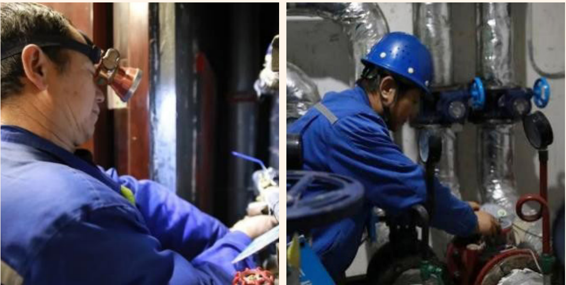
维修队成员在热站检查管道情况
