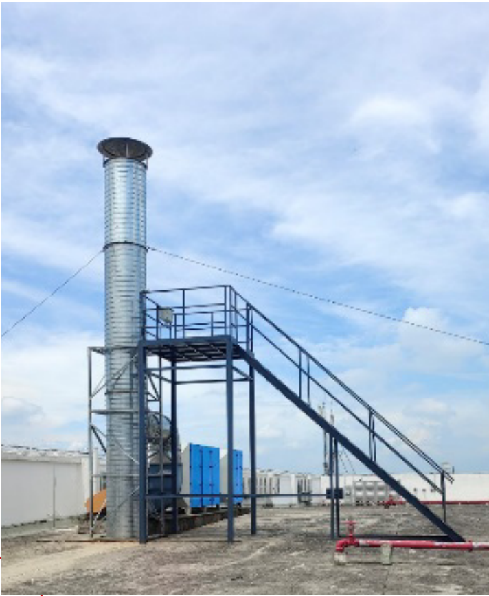
● 废气治理设施
