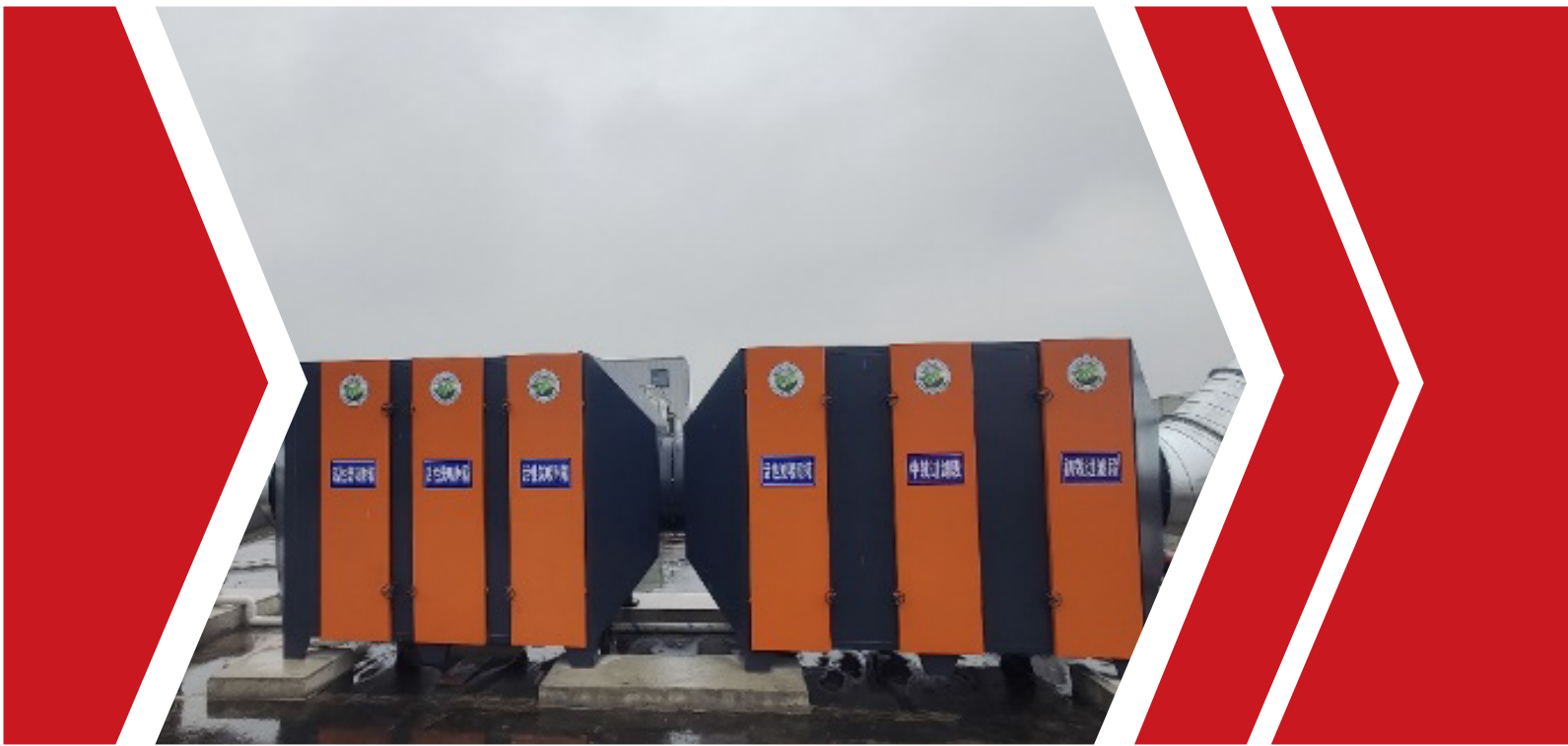
● 废气治理设施
