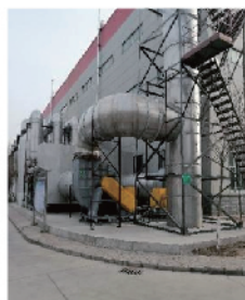
图片：VOC废气治理净化装置
