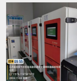
废水排放在线监测设备
