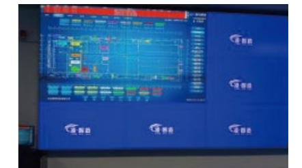
动力设备运行智能监控平台
